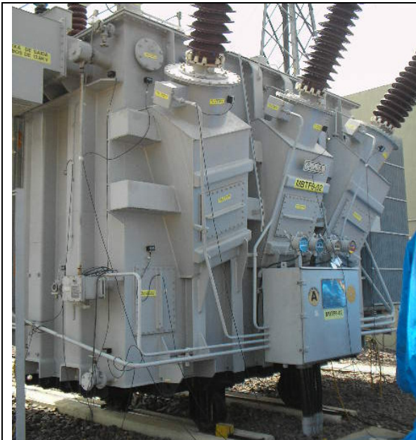
Figura 3 – Vista geral do transformador trifásico 230/69 kV ensaiado
